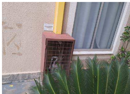
Foto 10: Medidor de gás do bloco 08
